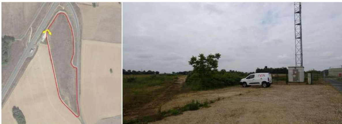
Figure 162 : Photographie du poste de transformation électrique de la LGV Sud Europe Atlantique et de l'entrée clôturée de ce dernier
